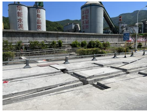
车辆冲洗设施废水收集沟
