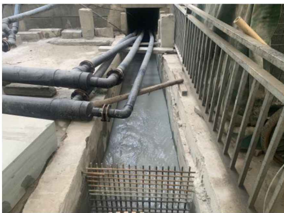
照片 5：项目区原石材加工车间内废水收集沟
