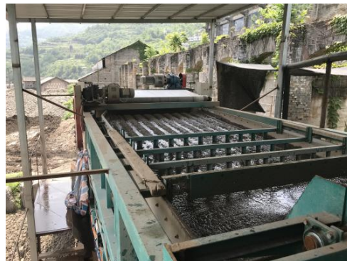
压滤机运行情况
