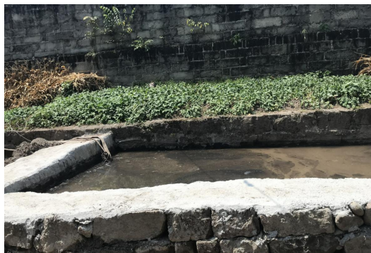
堆场废水收集沉淀池
