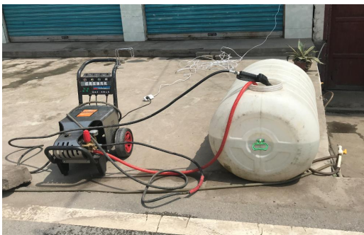
道路洒水设施
