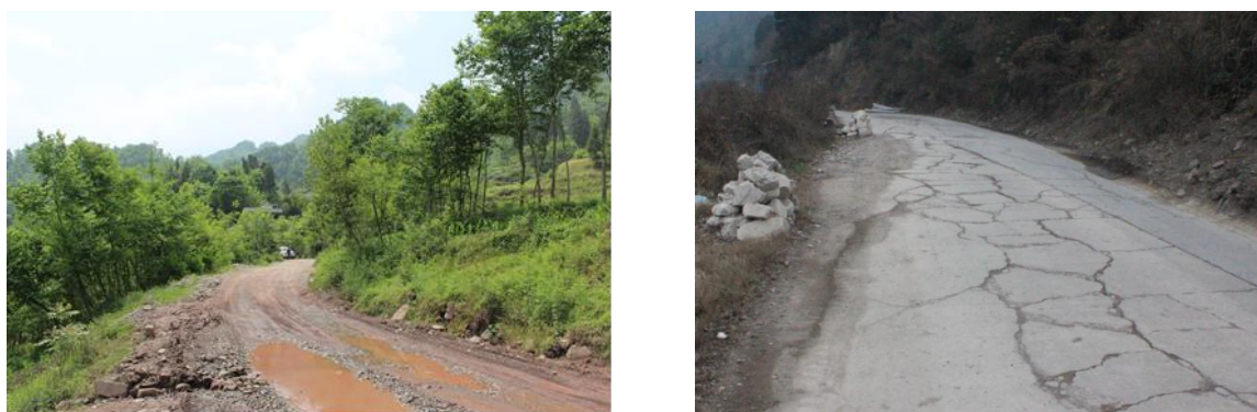
图 1-3 现状路面破损情况
